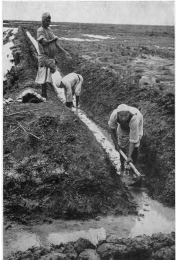
Bild 4: Aushub der Be- und Entwässerungsgräben in Abis. Es wird auf Grund niedriger Löhne noch viel Handarbeit geleistet.
