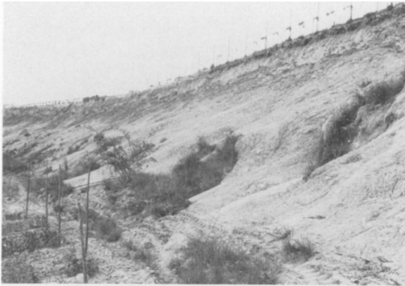
Photo 2: Beispiel einer Böschungsrutschung vom Juni 1978 am Engertweg/Buckkünzig (Aufnahme: G. LUFT, 6/1978) Example of a slumping in June 1978
